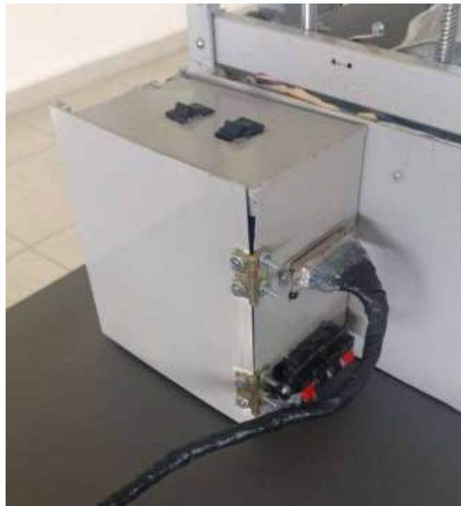
Figura 66. Caja de poder (gabinete de distribución eléctrica).
