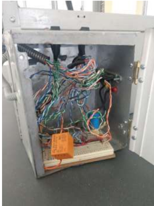
Figura 71. Interior de gabinete de distribución eléctrica.
