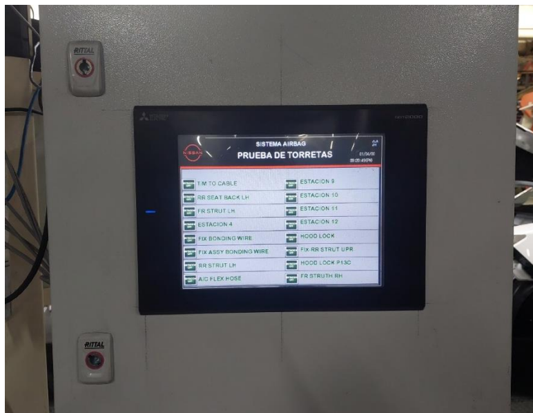
Figura 3. PLC de torretas.
