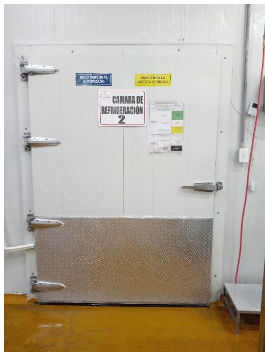
Figura 9. 6 Cámara de refrigerio en donde se almacena el producto. Fuente propia 2024.
