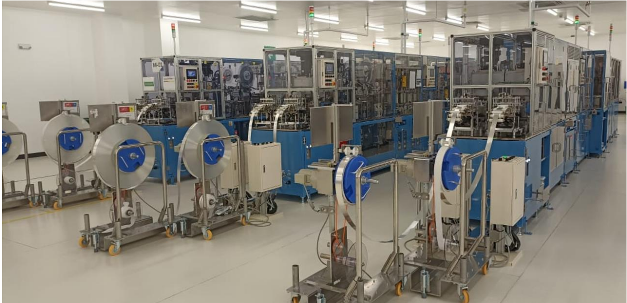
Ilustración 36 "Instalación terminada para máquinas Laminadoras PLUS" (Fuente: Judd Wire, 2024)
