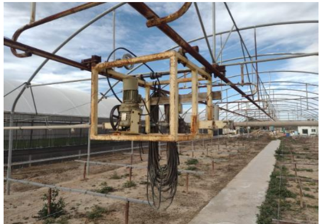
Imagen 5: equipo aéreo dañado
