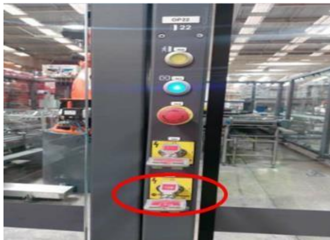
Ilustración 3.0. Se muestra la llave que se retira al entrar.
