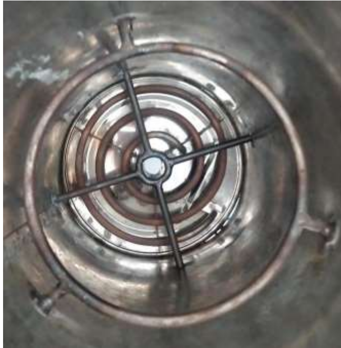
Figura 60. Vista de la resistencia eléctrica en el interior (fondo) de la carcasa.
