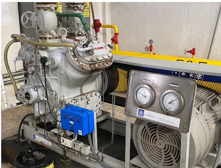
Figura 13. Aquí podemos observar el compresor de la empresa donde está compuesto por bandas y un rotor grande con amperímetros para poder medir su presión de aceite y líquido.
