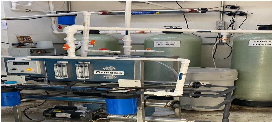
Figura 11. Esta imagen nos muestra la purificadora como podemos ver esta conformados por tuberías y tanques de filtros máquinas y niveles.
