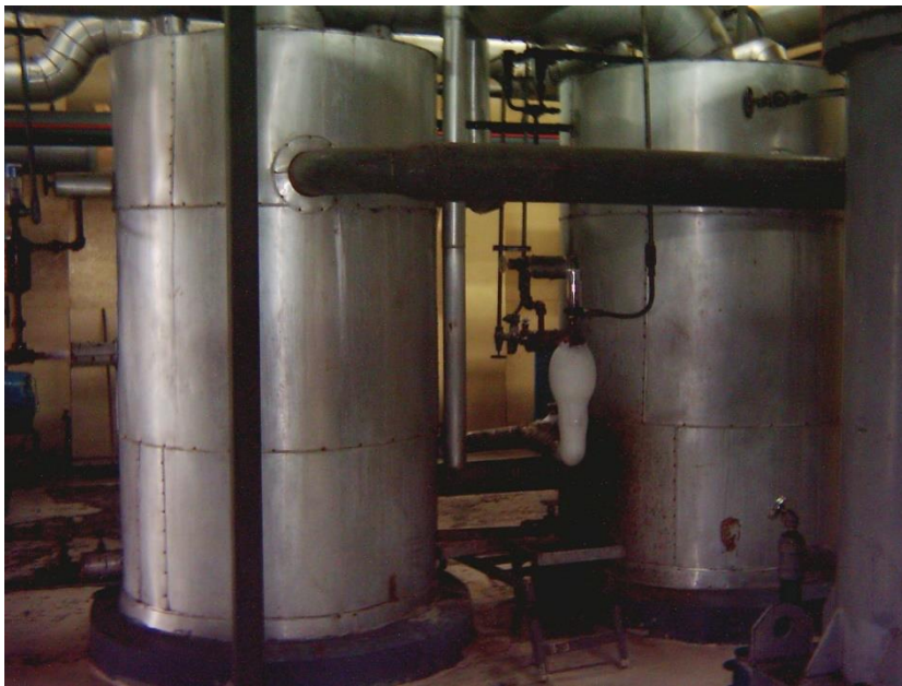
Figura 15. Esta imagen nos muestra un intercoolers como se puede apreciar también son tanques de aluminio que van conectados a tuberías.
