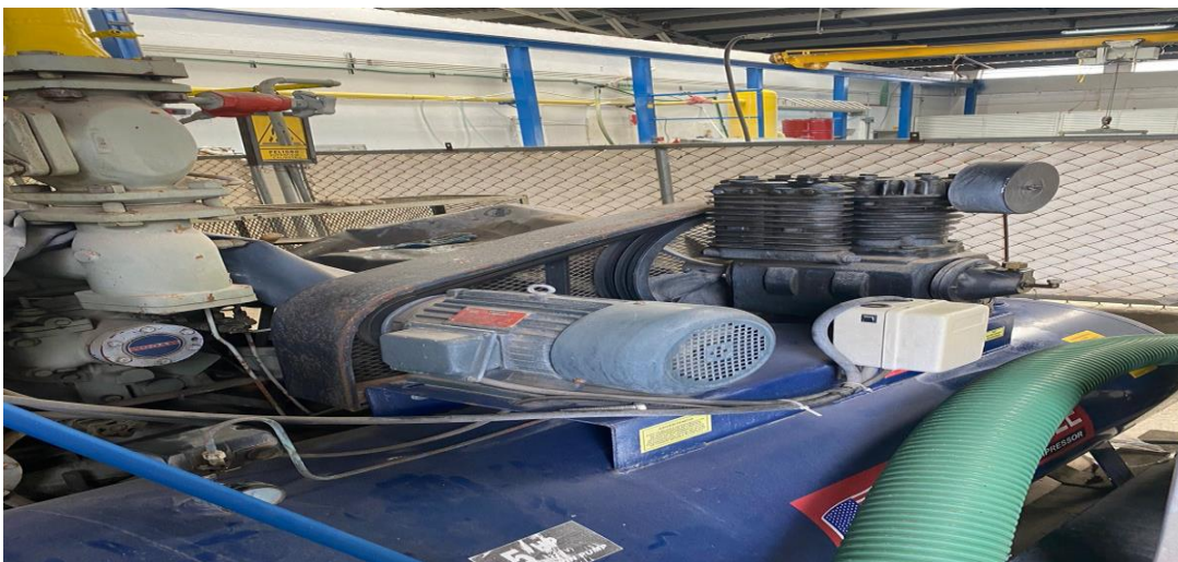
Figura 12. Esta imagen nos muestra el compresor que es el encargado de suministrar el aire.
