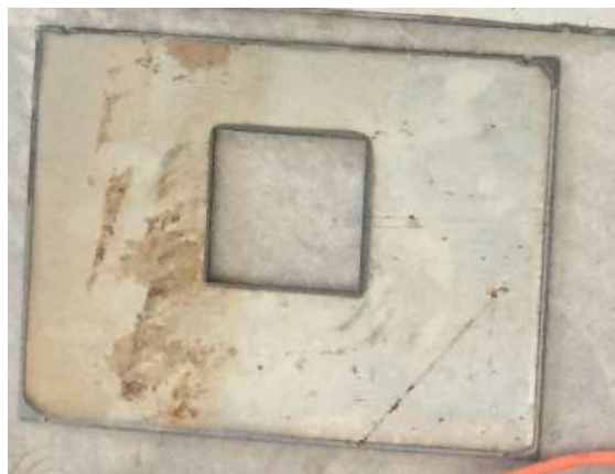
Figura 37. Tapadera del sistema eléctrico.
