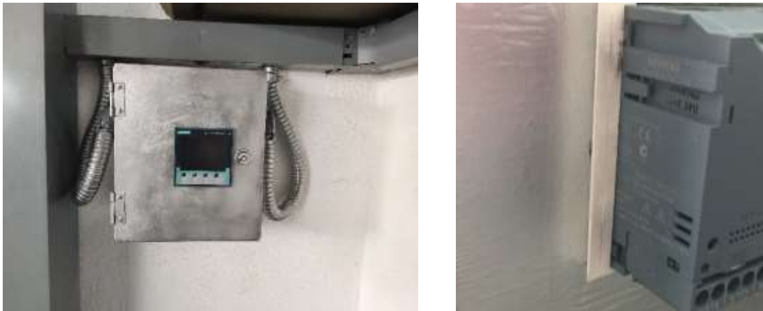
Figura 46. Sentron PAC3100 con sistema de fijación al gabinete eléctrico.
