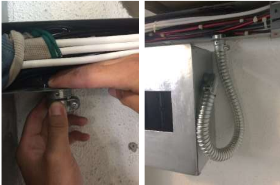
Figura 45. Coplee, Manguera y Codo para el paso de cableado eléctrico.
