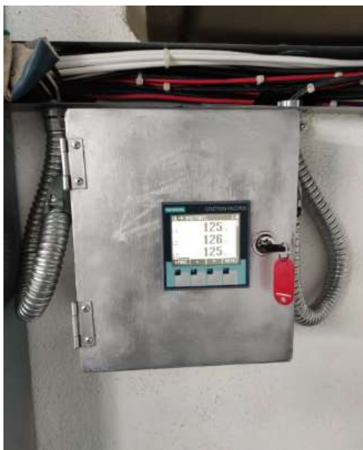
Figura 53. Sistema de monitoreo instalado.
