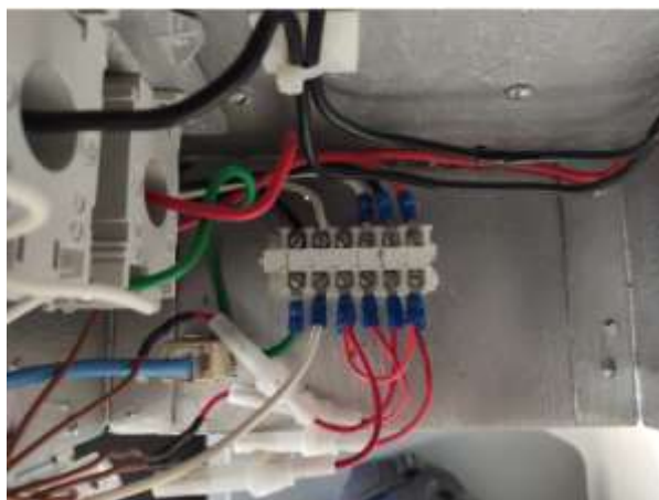
Figura 51. Bloque de terminales.
