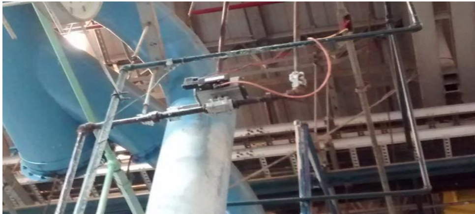
Figura 61 - Conexión a las electroválvulas de los serpentines.
