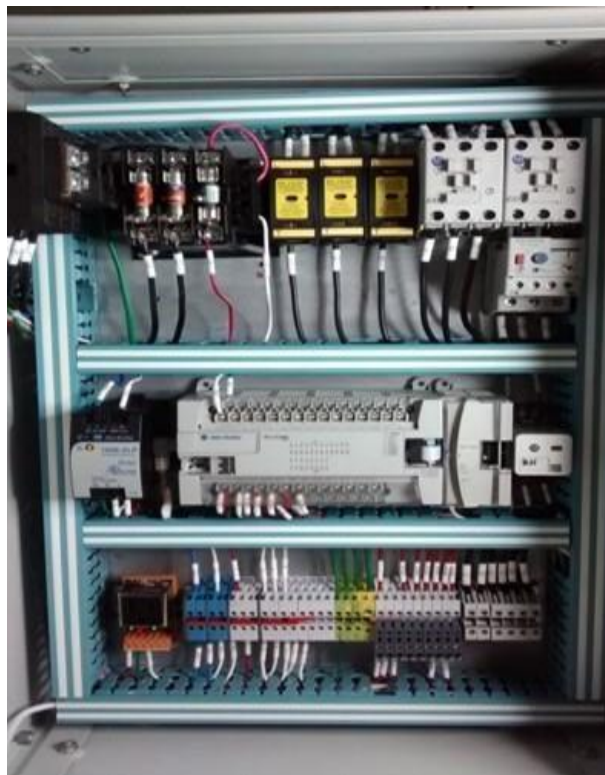
Figura 22 - Tablero cableado y etiquetado al 100%.
