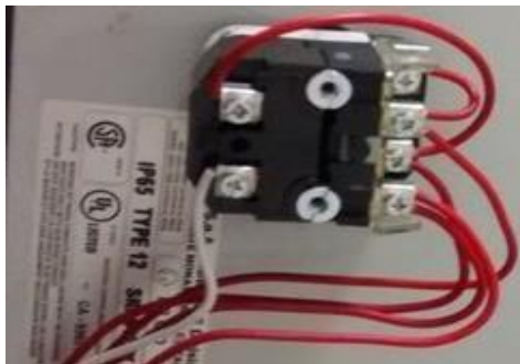
Figura 20 - Cableado del control maestro.
