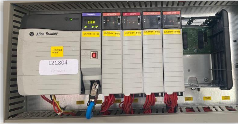
Figura III.4 Mantenimiento PLC Allen-Bradley. Fuente: CyCNA, 2023
