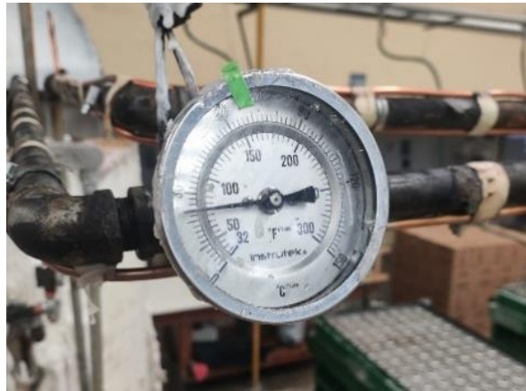
Ilustración 4. 28 Termómetro tanque 1. Fuente: Elaboración propia. 2024
