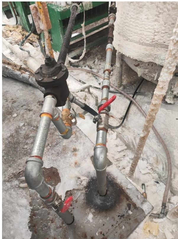
Ilustración 9. 12 Tubos de Vapor. Fuente: Elaboración Propia. 2024
