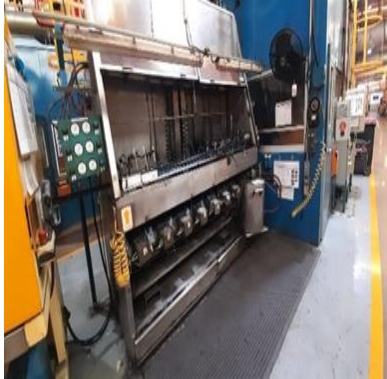
Ilustración 25 Cabina de Coating
