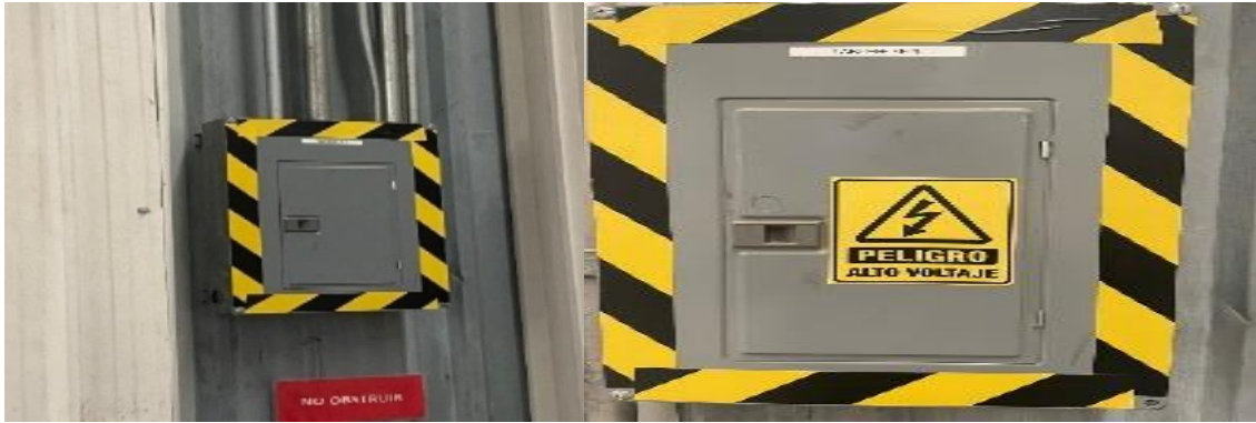
Ilustración 50, Tablero Eléctrico Sin Señalamiento de Riesgo, Elaboración Propia.
