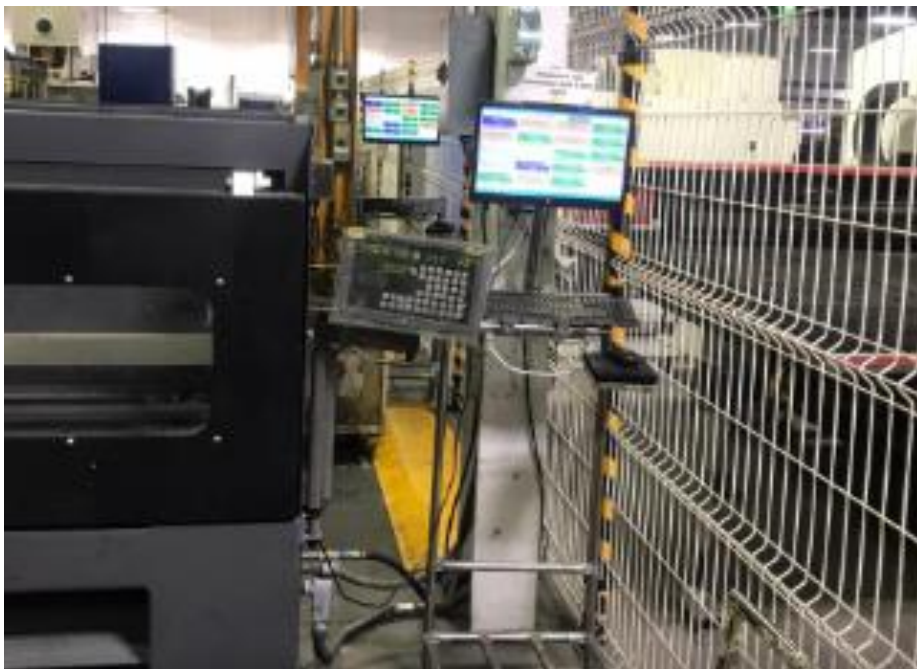
Ilustración 34 Equipos en estación de sierras.
