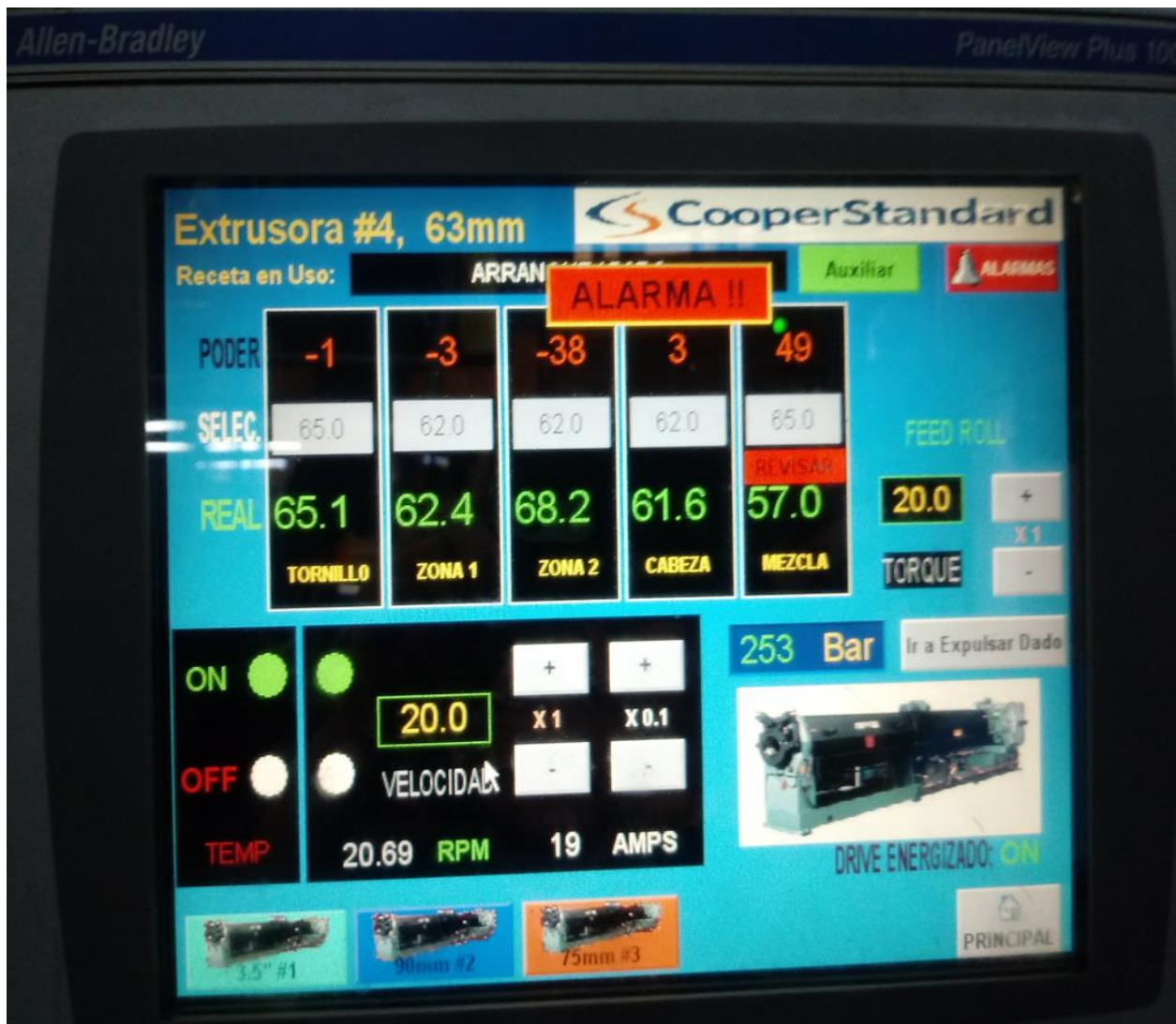
Ilustración 20 Panel de control
