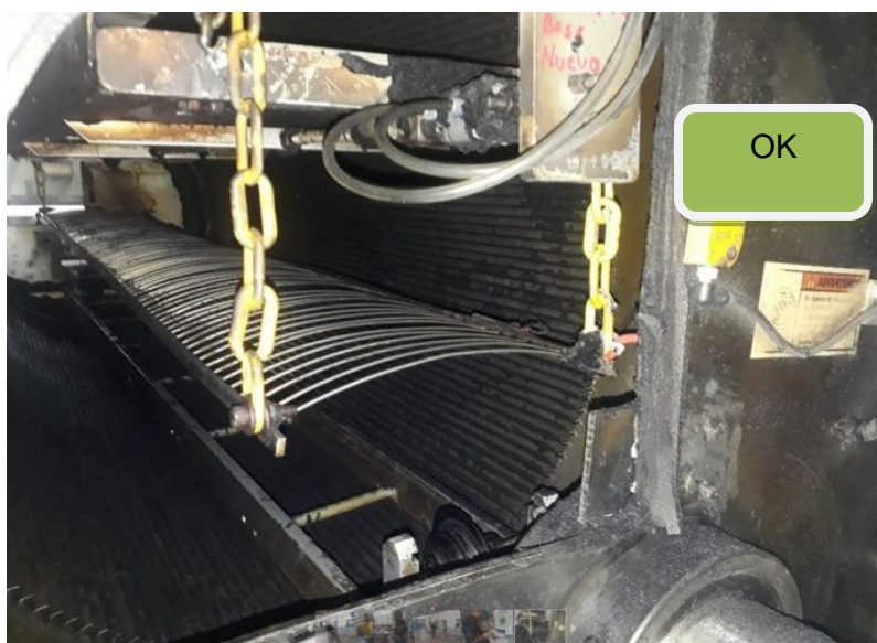
Ilustración 100, evidencia de cabina limpia.
