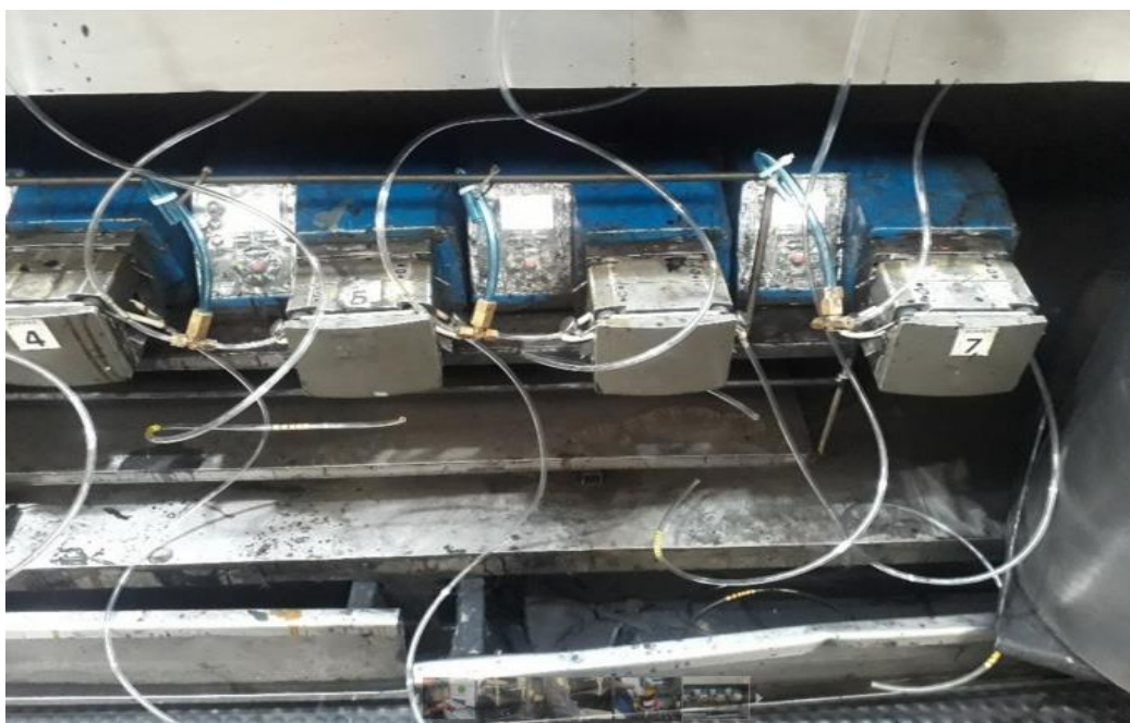
Ilustración 53, mangueras nuevas instaladas.
