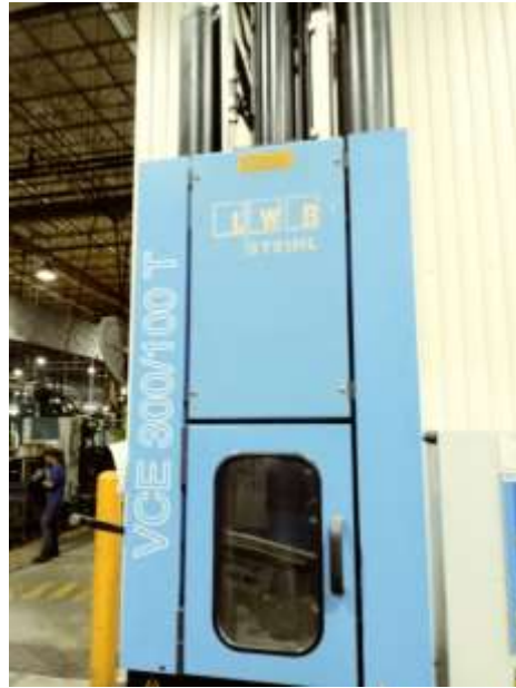
Imagen 34. Falta de HOE en la maquinaria
