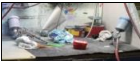
Imagen 17. Almacenamiento de materiales incorrecto.
