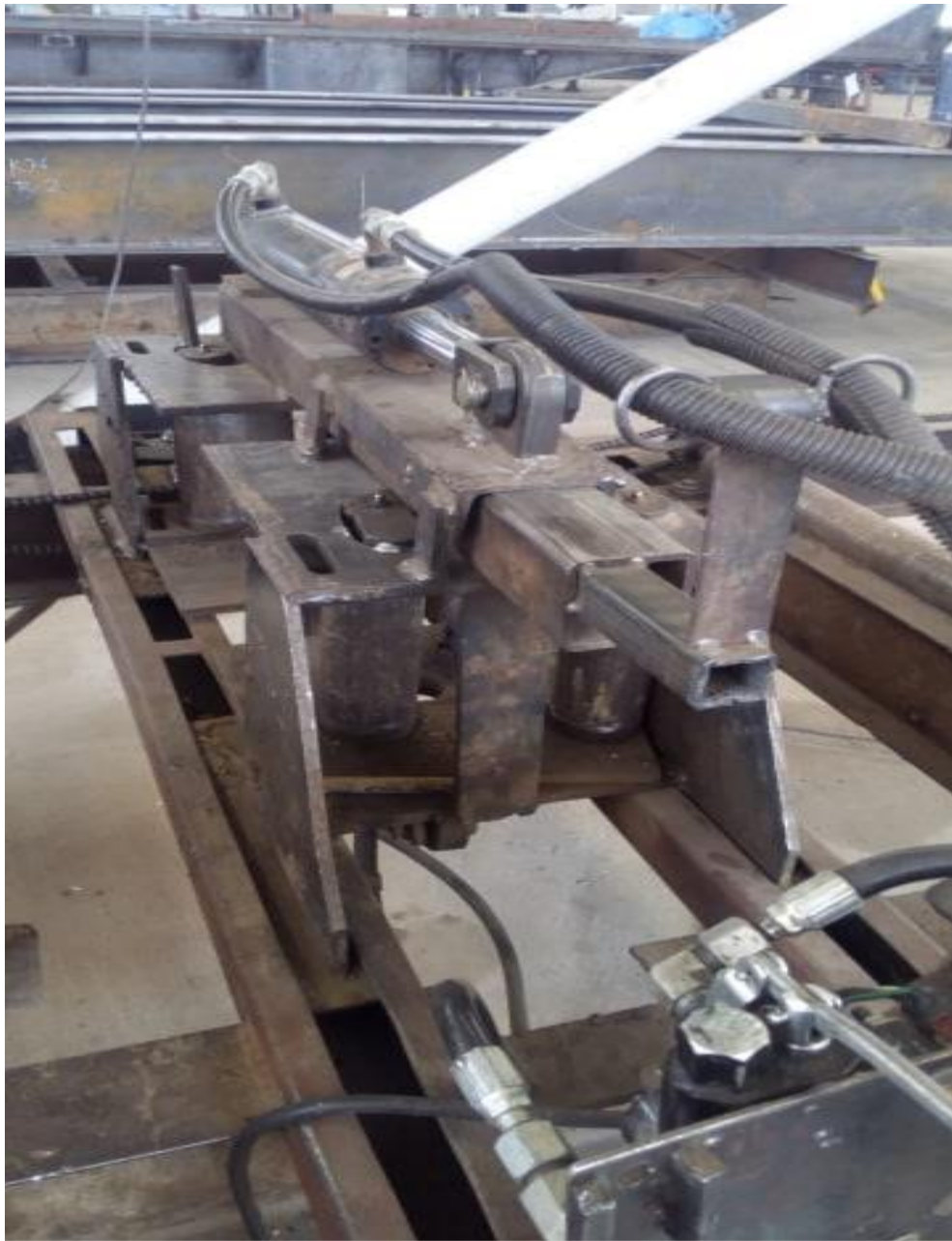
Imagen 32. Representación de instalación de gato hidráulico para el ajuste del armado de vigas
