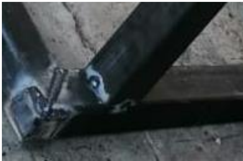
Ilustración 51. Refuerzos soldados a la maquina
