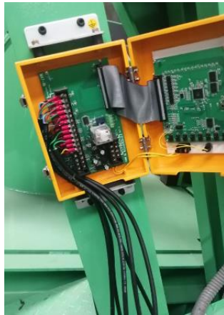
Figura 72 Conexión de Tapetes de seguridad.
