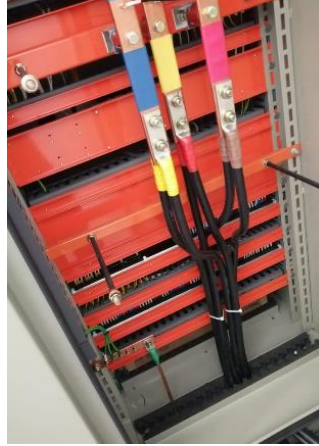
Figura 53 Conexión de Alimentación
