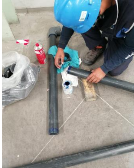
Figura 47 Tubos para alimentación Hidráulica
