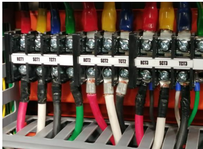
Figura 69 Conexión motores en panel principal
