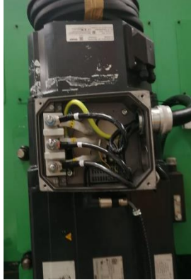
Figura 59 Motor Trifásico 440v.
