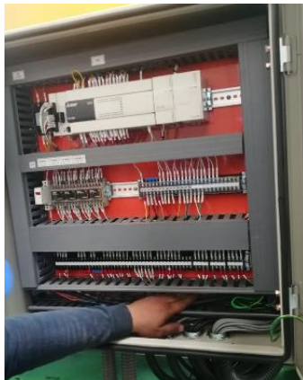
Figura 73 Caja de PLC
