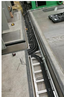
Figura 61 Charolas con cable de maquina 1
