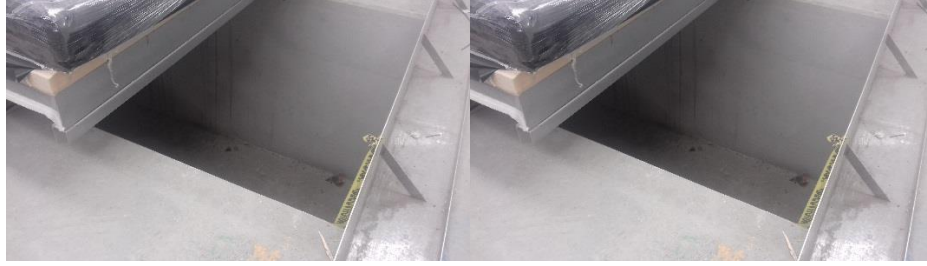
Imagen 2. Fosa de mantenimiento sin protección
