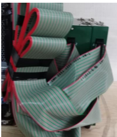
Figura 49. Cables planos en PHC2.
