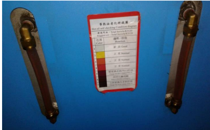
Figura 29. Aceite en mal estado.
