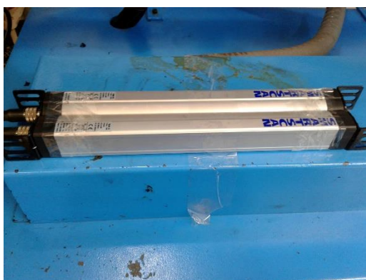
Figura 11. Barras fotoeléctricas descompuestas.
