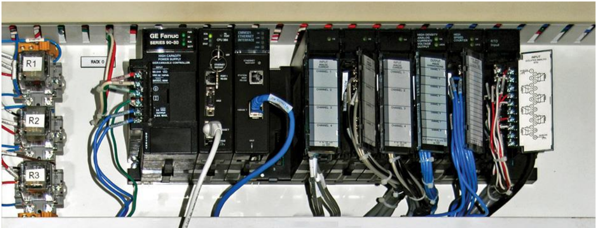
Figura 5. Imagen de un PLC en físico.
