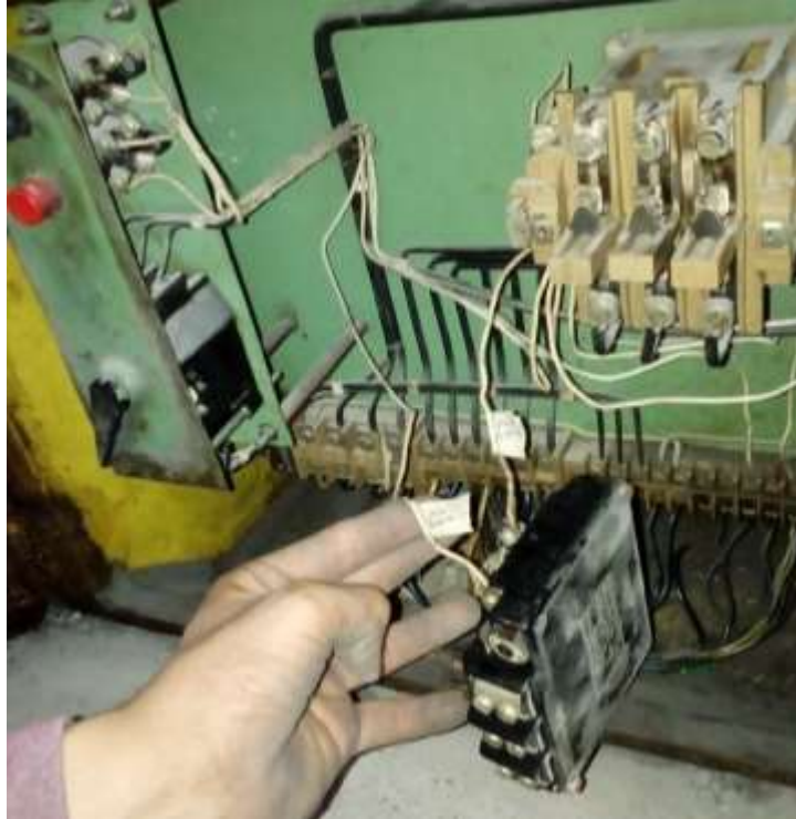
Fotografía 6. Máquina para realizar máquinados complejos. (Contactor Térmico)
