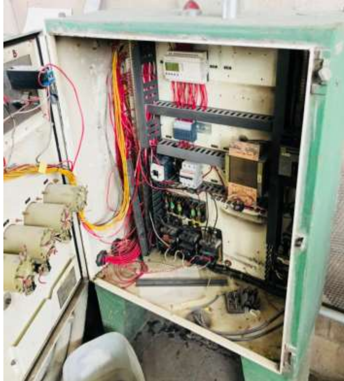
Fotografía 9. Máquina Inyectora de plástico. (Tablero de control)
