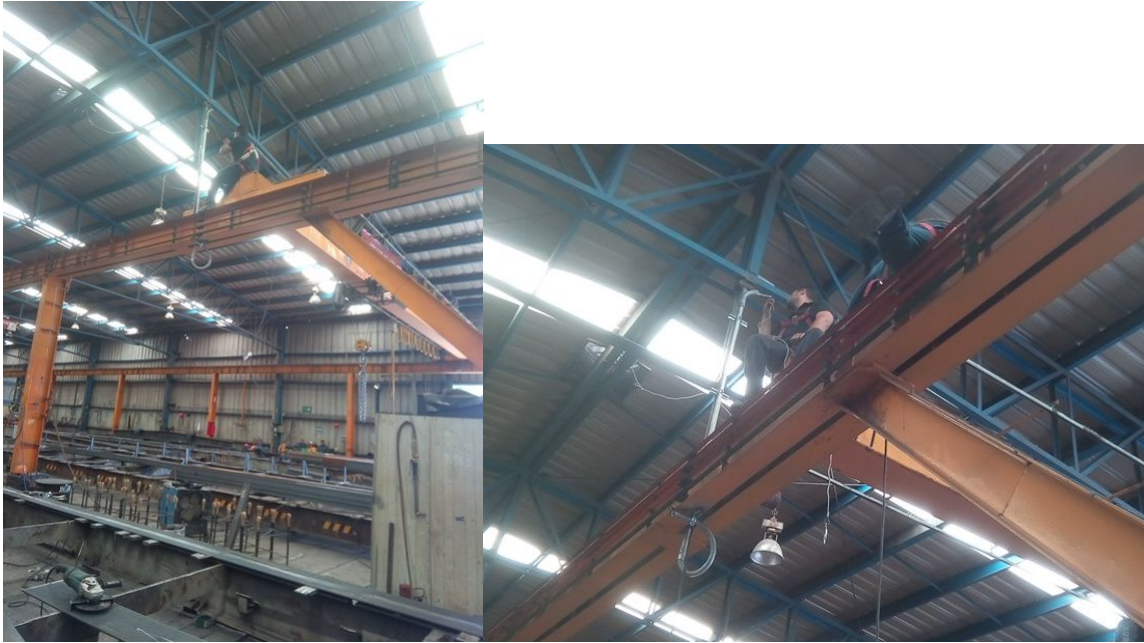
Figura 3.4 Acomodo de cable de red
