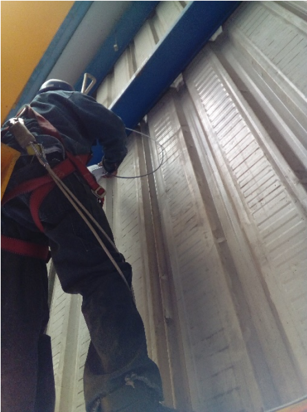
Figura 3.2 Instalación de repetidor en taller de fabricación.
