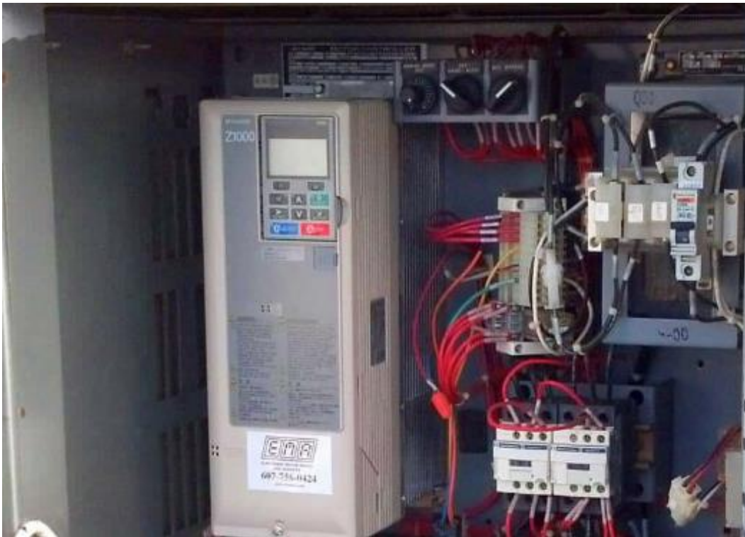
Fig. 1 Variador de frecuencia.
