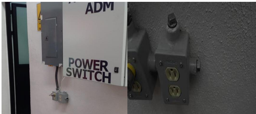
Figura 6. Ejemplo 1 riesgo detectado en recorrido de seguridad
