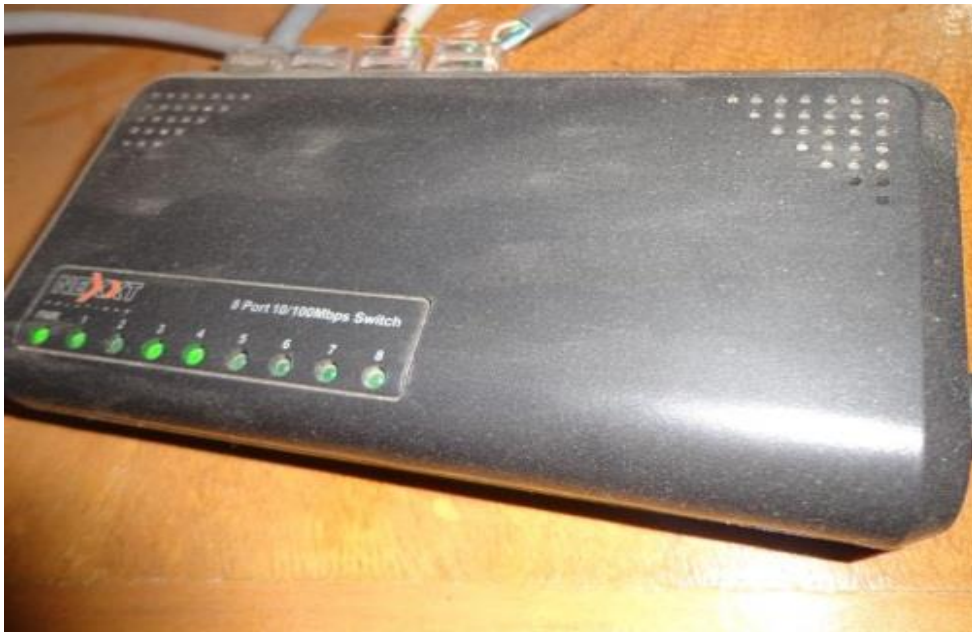
Ilustración 35: Conexión de cables en red
