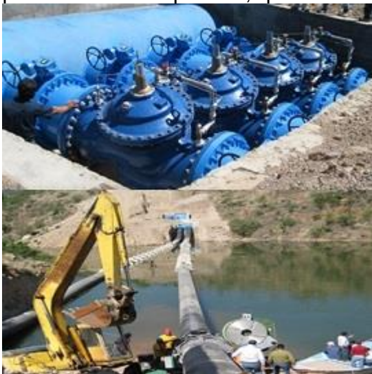
Válvulas Reductoras y Cruce Subacuático
