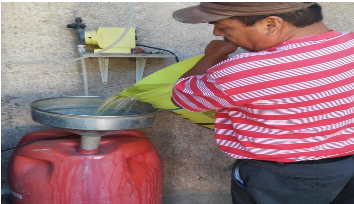
Figura 2. Suministro de Cloro, Pozo Plaza Principal
