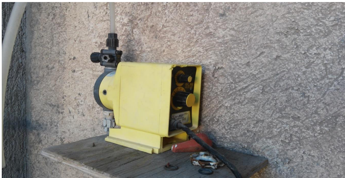
Figura 3. Aparato dosificador de Cloro, Pozo Plaza Principal
