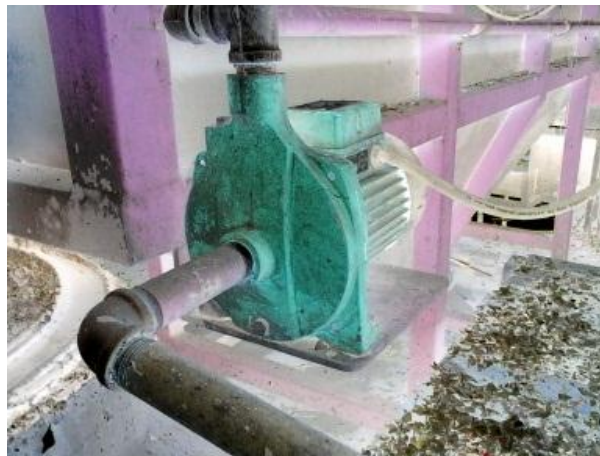
FIGURA 15: Bomba de recirculación de tina de flotación.
