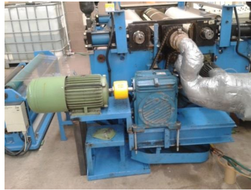
Fig.3.6: Motor y reductor de la embozadora.
