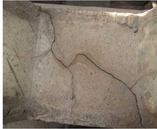
Fig. 7 Ejemplo de fisura.
