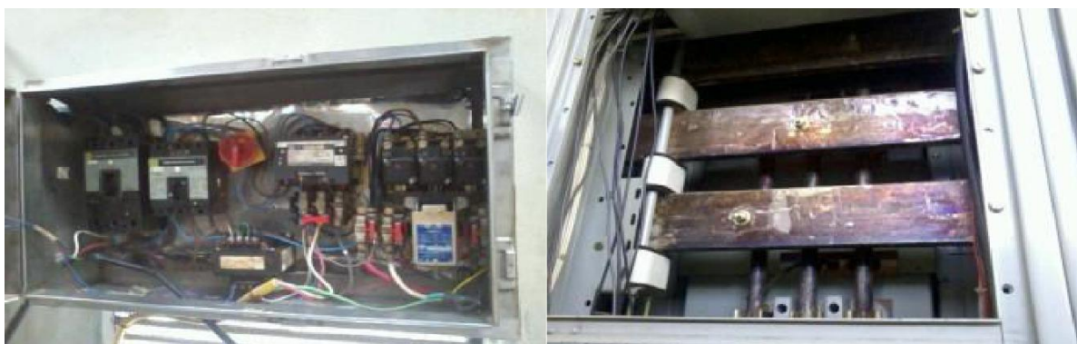
Fig. 3 Tablero de control y fuerza.
