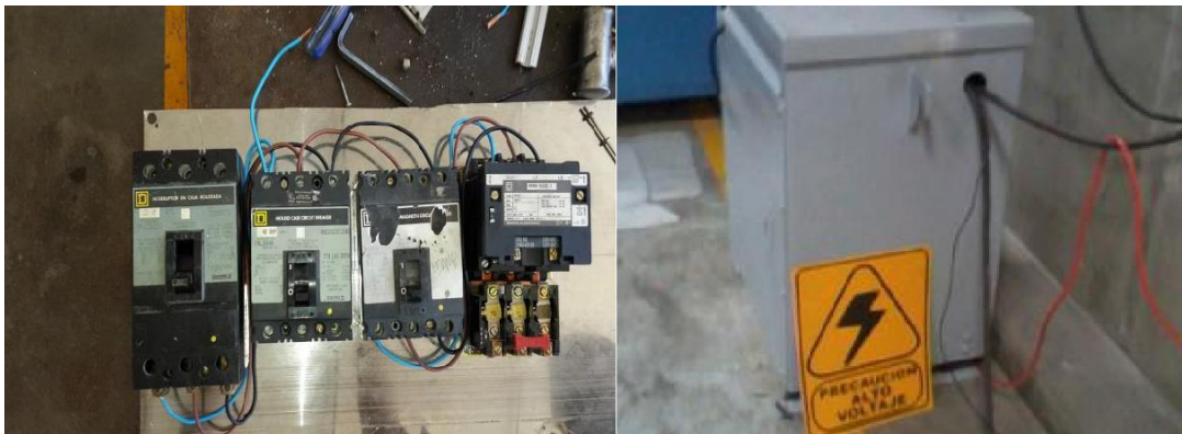
Fig. 11 Control de transformador.
